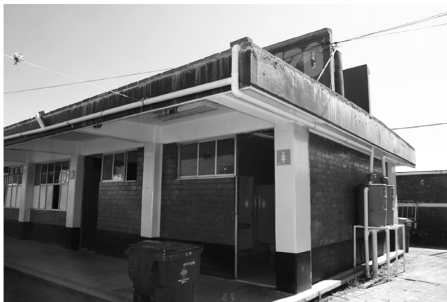
Figura 5. Vista de sistema de captación de lluvia, Secundaria 120 (Isla Urbana, 2012).
